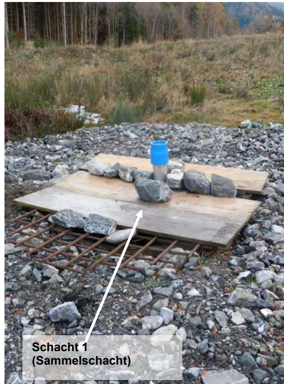
Messstelle Schacht 1 (Sammelschacht – S1)
